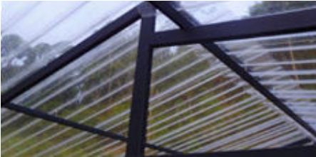
Ilustración 50. Ventilación superior en invernaderos.
